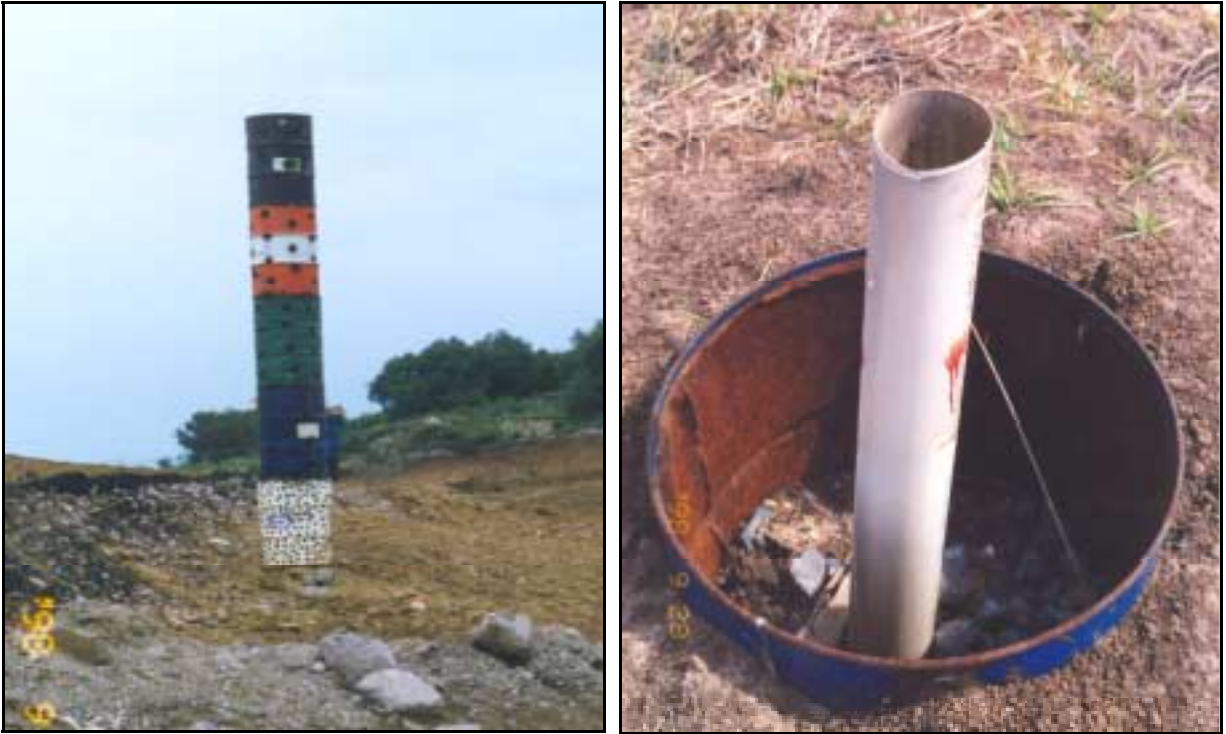
Figura 8 y 9: Sistemas simples de captación de biogás (Fotografía: G. Wehenpohl)
