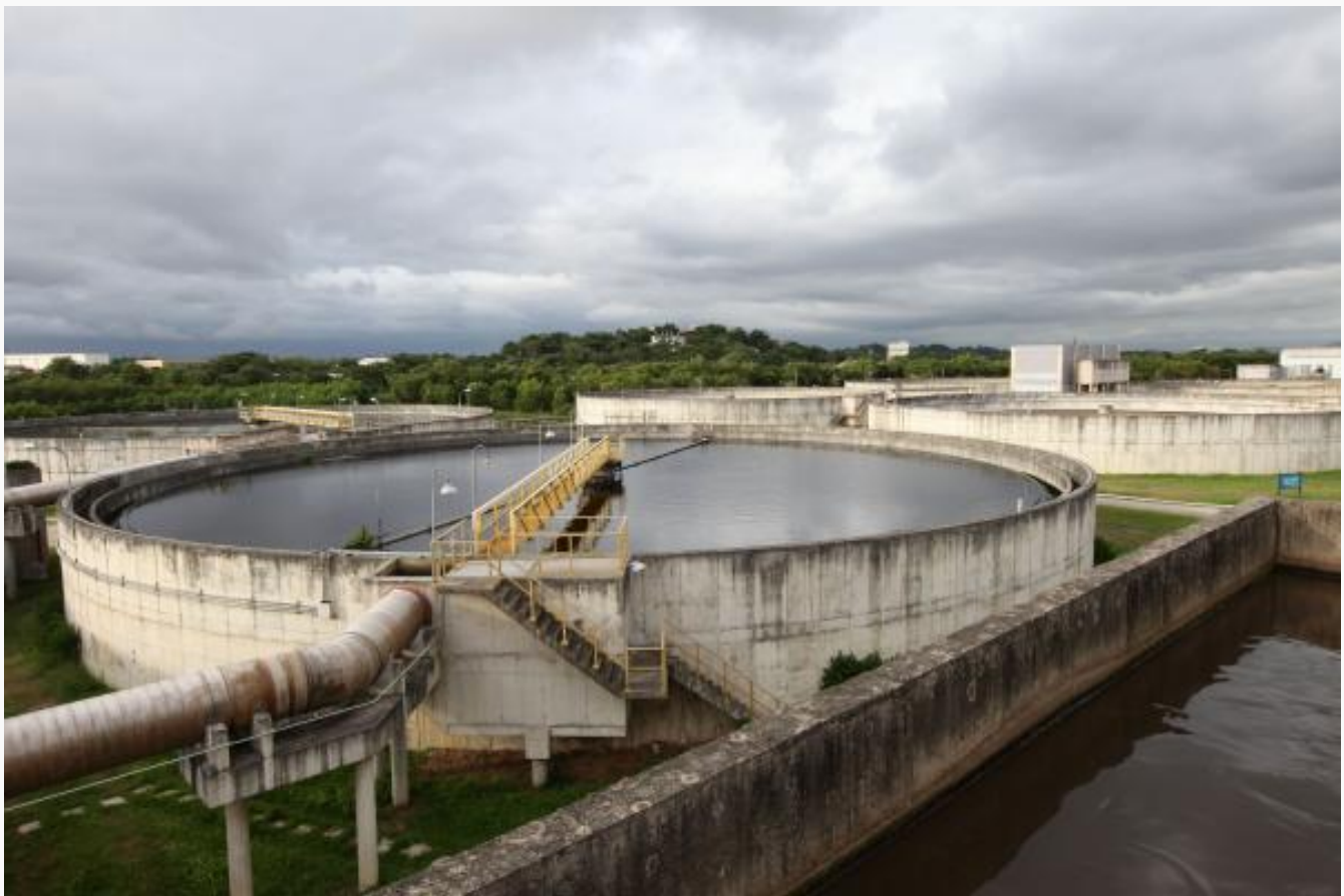
Estação de Tratamento de Esgoto
