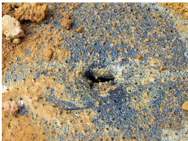
Fig. 7: Dano causado à geomembrana durante a instalação.
