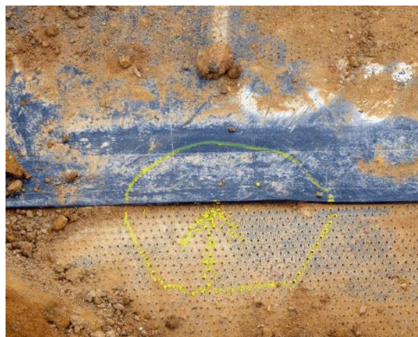
Fig. 8: Falha identificada na solda da emenda entre as geomembranas.
