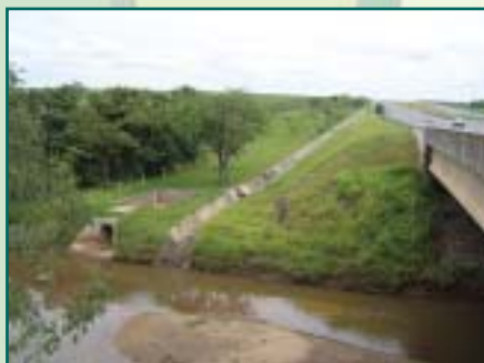
Prevenção de contaminação pela instalação de caixa de contenção em drenagem de rodovia
